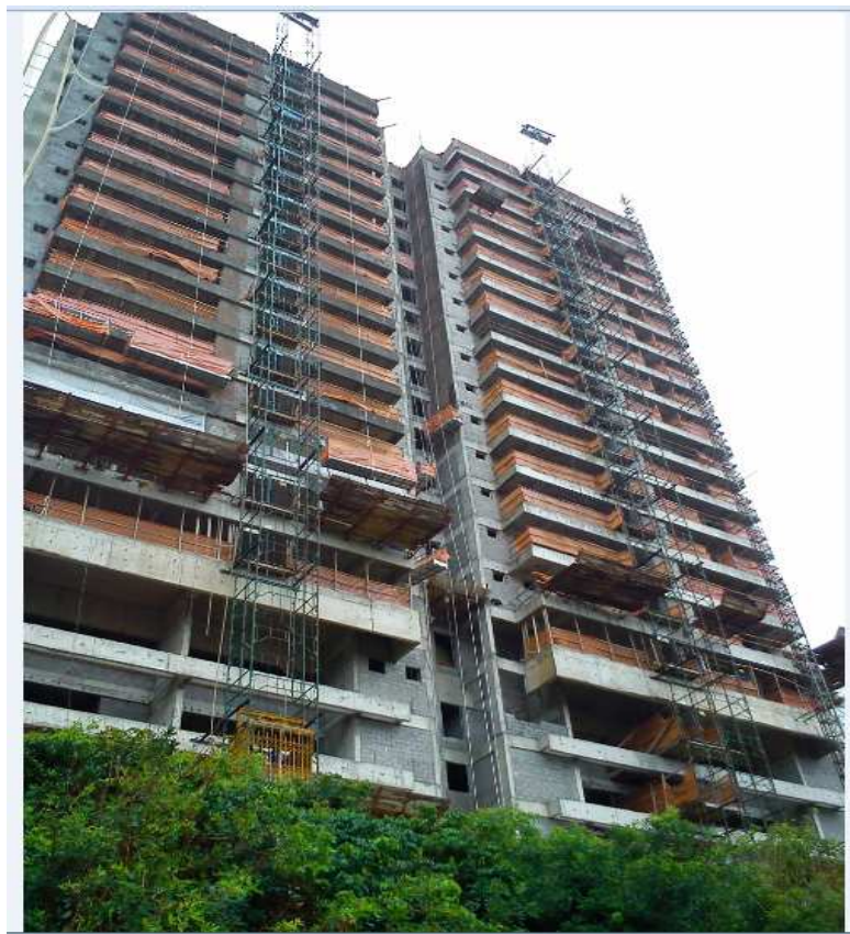
Figura 25 - Interferência dos elevadores na fachada. (Fonte própria)
