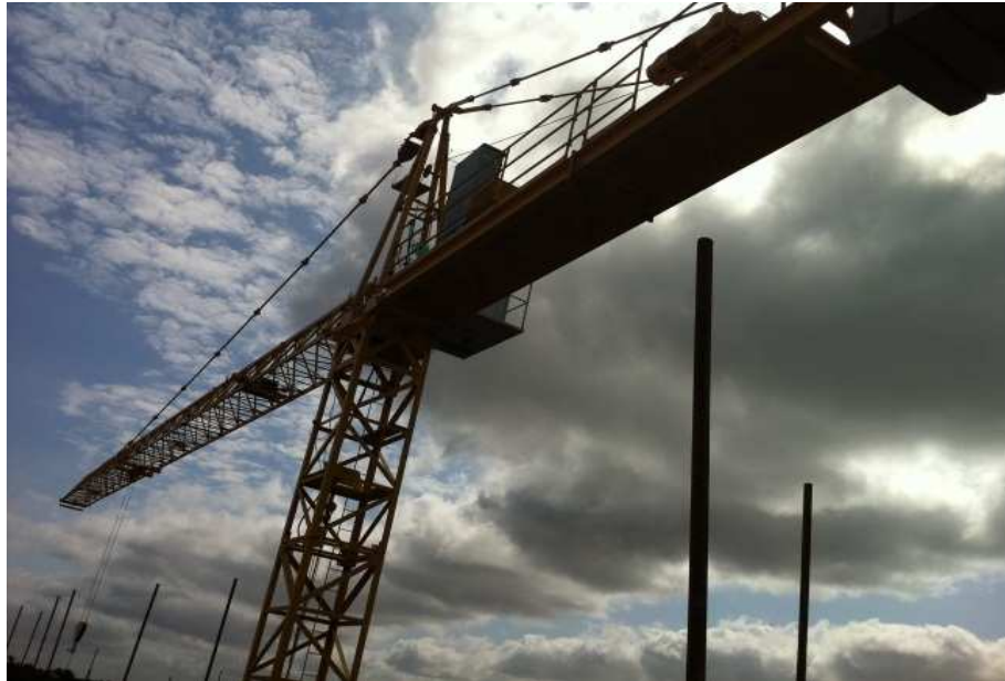
Figura 18 - Lança da grua. (Fonte própria)
