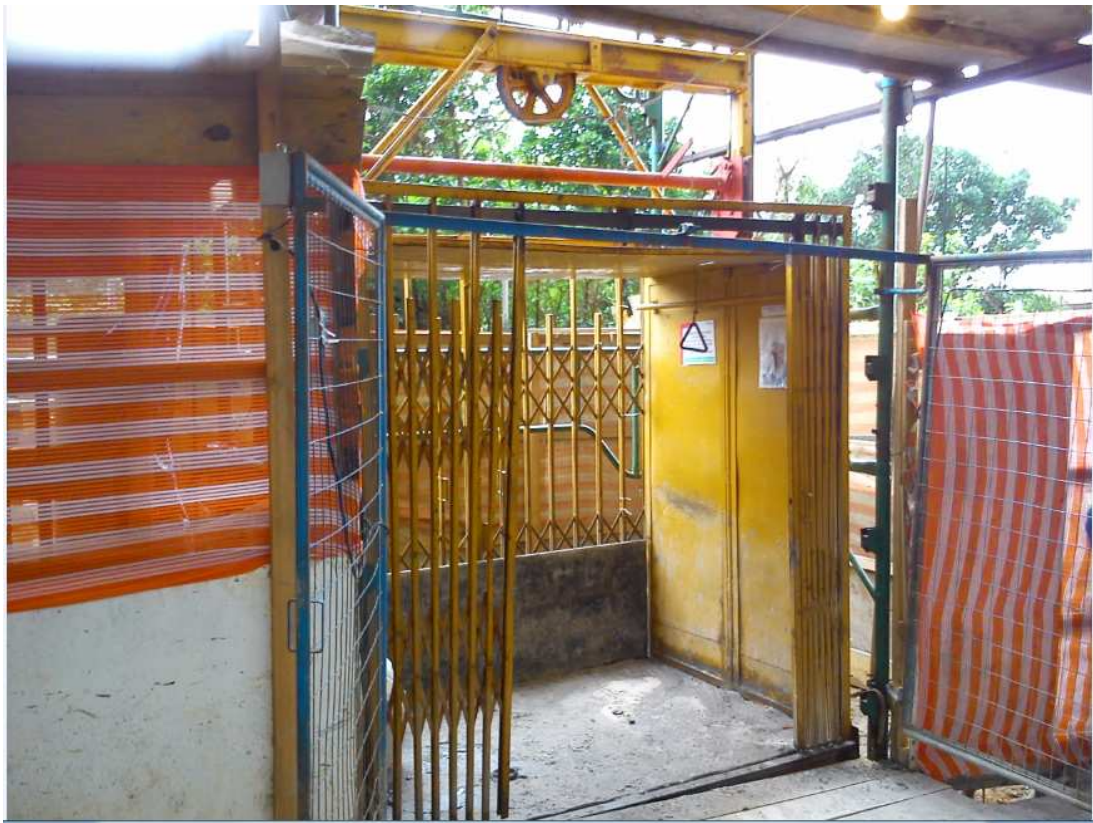
Figura 5 - Elevador a cabo (Fonte própria)
