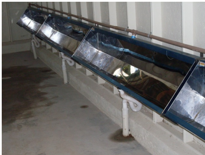
Figura 4 – Calha mictório Fonte própria
