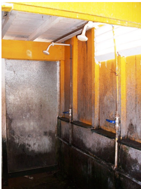
Figura 1 – Instalação de banheiro em canteiro de obra Fonte própria
